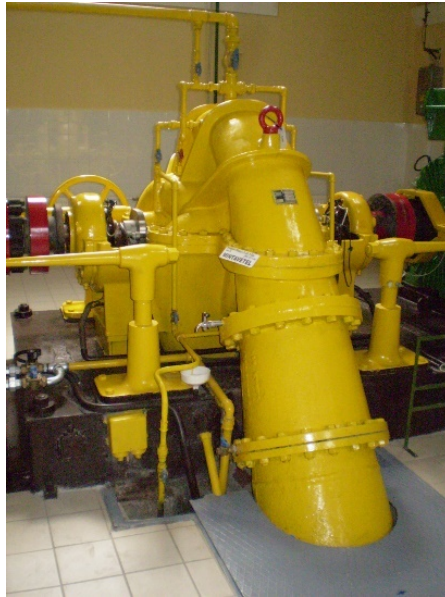
8. ábra: A felújított Ganz DAN-450 típusú szivattyú már a helyére beépítve
