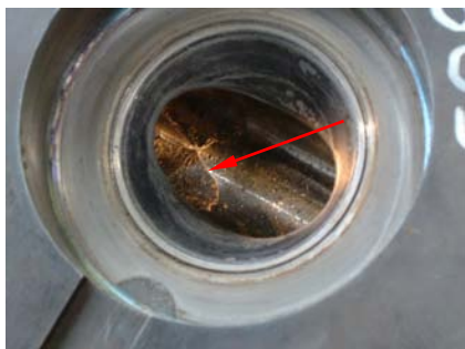
12. ábra: Korrozíós anyagfogyás a nagynyomású szelep alsó részén
